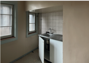
Cuisines et sanitaires obsolètes, à repenser.
