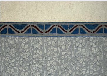
Décorations peintes dans les cages d'escalier, à maintenir et à restaurer.
